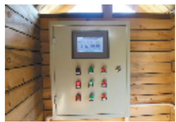
盐官镇桃园村农村生活污水智能管家
