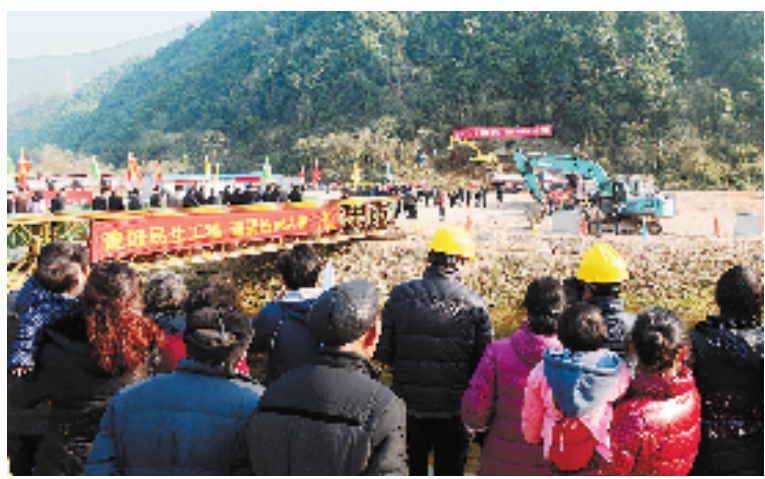
12月24日，千岛湖配供水一体化工程富阳狮子山工段开工。本报记者 黄曙林 胡元勇 摄
