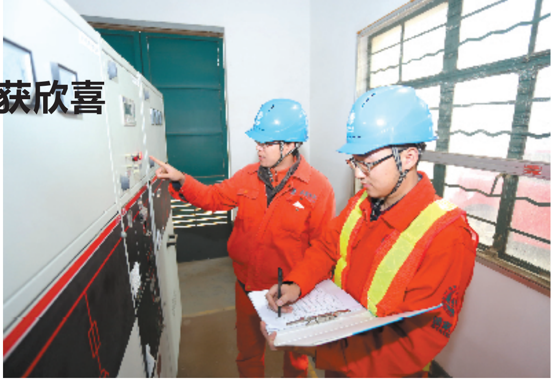
日前,湖州供电公司开展小区“三双”投切装置故障演练,有效检验了供电设备的安全性和稳定性,为小区居民冬季可靠供电提供有力保障。近年来,湖州供电公司统一规划、分步实施、持续提升,加快城区“三双”接线配网改造,目前总覆盖面积达32.63平方公里,惠及低压客户近15万户。
