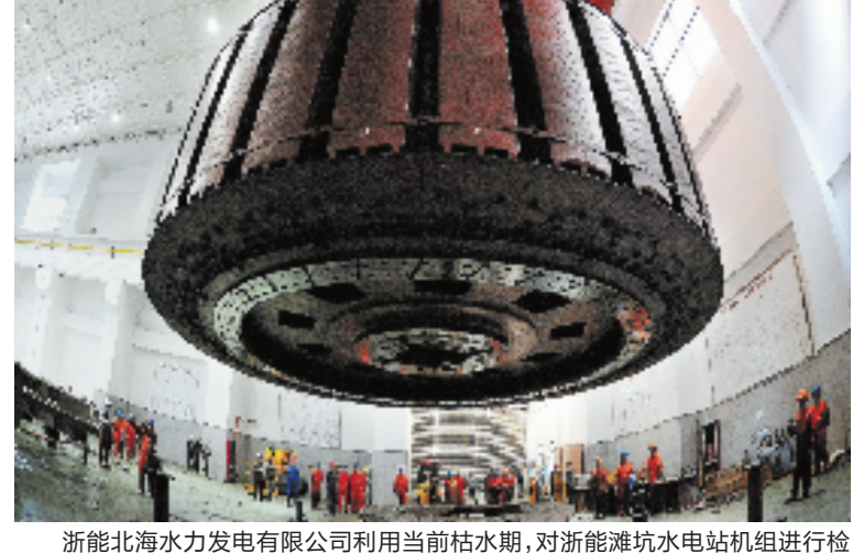
浙能北海水力发电有限公司利用当前枯水期,对浙能滩坑水电站机组进行检修。滩坑水电站装有全省最大单机容量的3台20万千瓦常规水发电机组。图为直径10米、重达450吨的电机转子。
