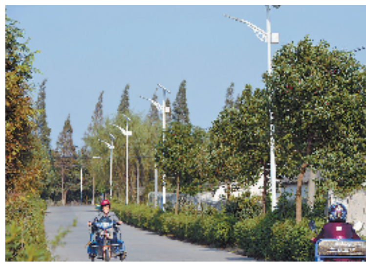
近日,桐乡市石门镇桂花村总投资约50万元的太阳能LED路灯全部在村道上安装到位,不仅给村民夜行带来了方便,也给乡村增添了美景。叶寒青 张潘丽 摄
