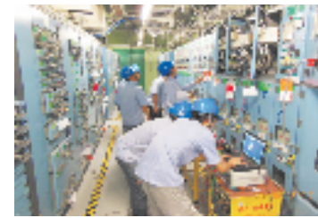
方家山中压段安全母线及柴油机与DCS 1E级相关试验 朱海田 摄
