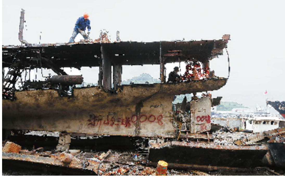
9月16日,在温岭市松门镇礁山港的温岭兴源船舶修造厂内,一艘30米长的“三无”钢质渔船正在被拆解。
