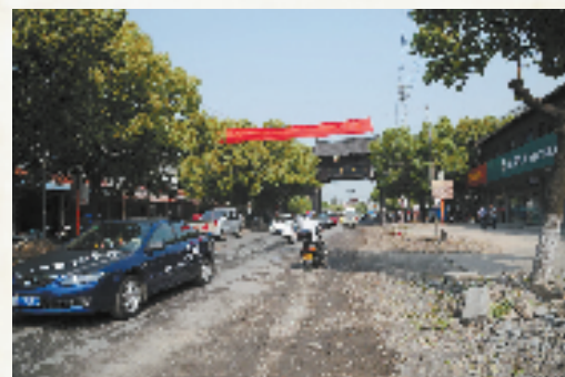
乌镇景区牌楼前路面整治前
