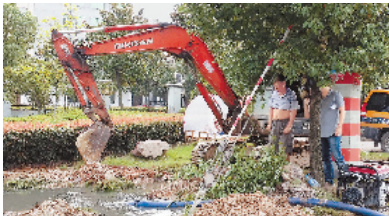
图为污水管道破裂现场。
