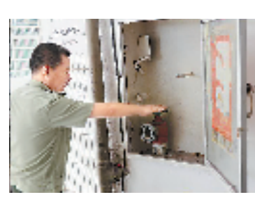
平阳鳌江家电城火灾隐患多,从左至右依次为:消防栓箱无水带、水枪和水;建筑间违法搭建;灭火器压力不足。 余根岭 摄
