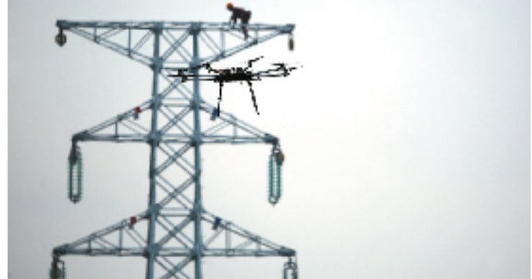
9月4日上午,宁海黄坛村110千伏青竹线改造现场,宁波供电公司首次运用无人机架设引线成功。
