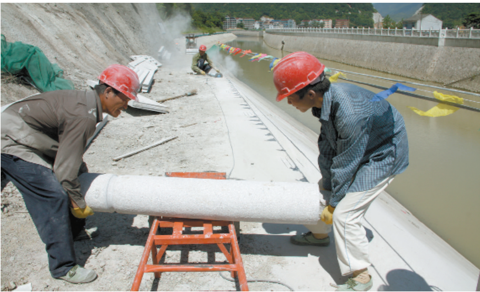
工人们在永嘉下塘西前村段加紧安装堤防栏杆。县委报道组 叶圣义 摄
